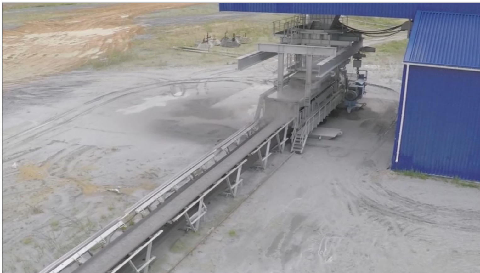
Фото 5 – Узел пересыпки на ленточный (реверсивный) конвейер на золоотвале №2 Рефтинской ГРЭС
